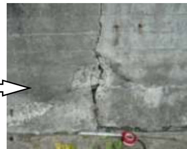
堤防のひび割れ
