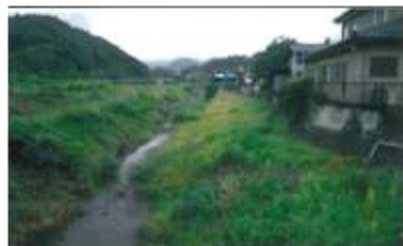
土砂の堆積状況
