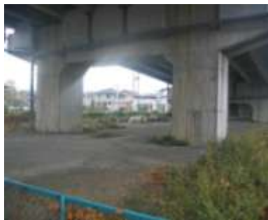
<橋りょうの耐震補強 整備例:施工前 (国道115号:方木田跨線橋)>
