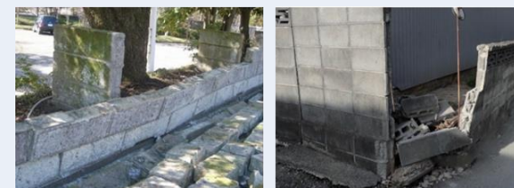
<コンクリートブロック塀や石塀の倒壊状況>
