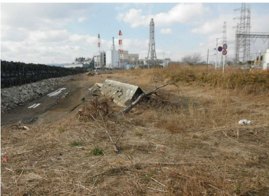
▲津波で壊れた防潮堤の一部
