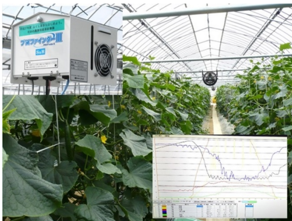
園芸施設の環境測定装置
