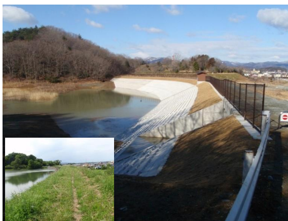
決壊による家屋等の被害を未然に防止する 老朽化したため池の改修(左下:施工前)
