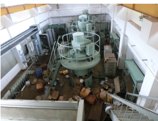
白沢揚水機場被災状況
