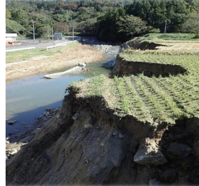
台風19号による被災(畦畔崩壊)
