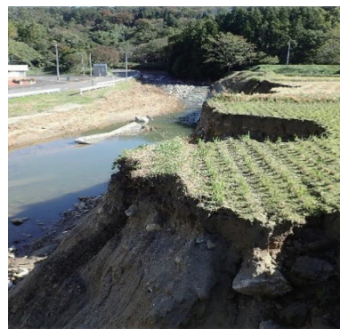
台風19号による被災(畦畔崩壊)
