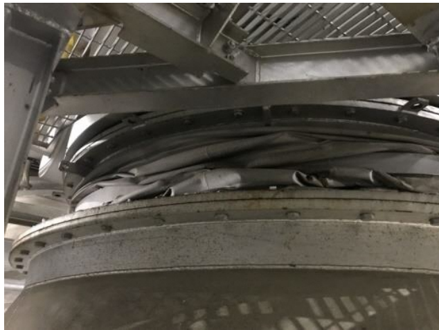
損傷した伸縮継手 （仮設灰処理施設その1）
