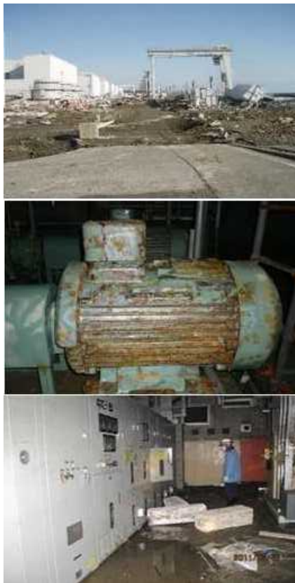
津波により被災
