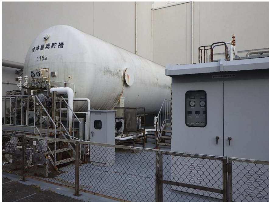
＜格納容器内ガス濃度制御系＞
