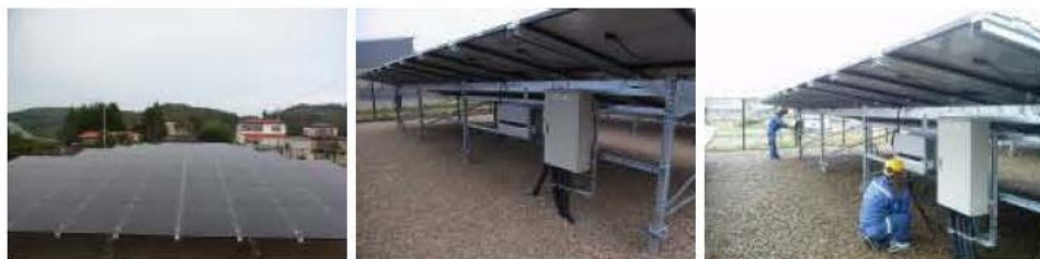
平成25年10月4日 太陽光パネル設置状況及びPC・交流集電盤
