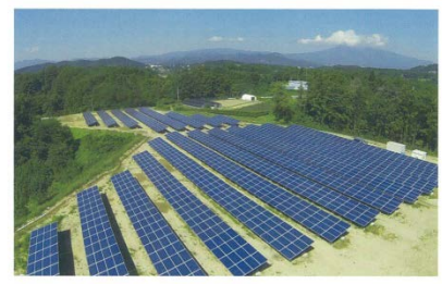
にしだメガソーラー発電所
