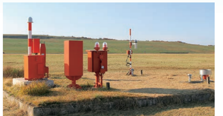
露場・雲高観測装置 気温・露点温度・降水量及び雲低の高さを測定する装置です。
