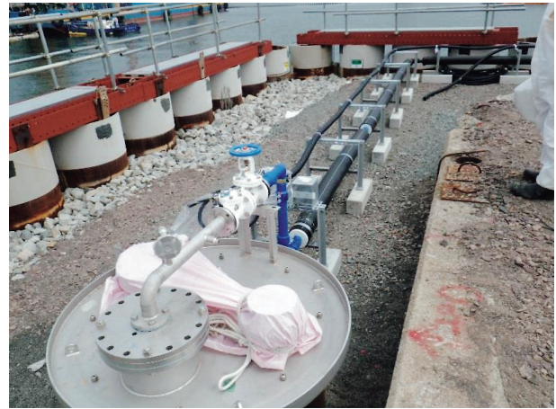
海側遮水壁と地下水ドレンポンド
