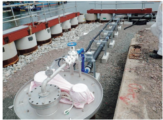
海側遮水壁と地下水ドレンポンド
