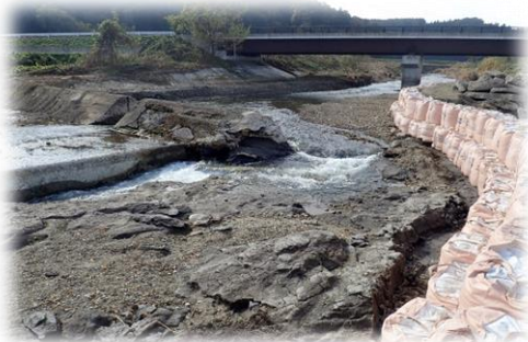
【護岸及び導水路が流失した農業水利施設】 (須賀川市)
