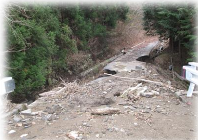
林道被害 畑田線の路体決壊状況 (田村市 大越地内)
