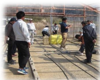
【ソーラー自動かん水システム設置研修会の様子】
