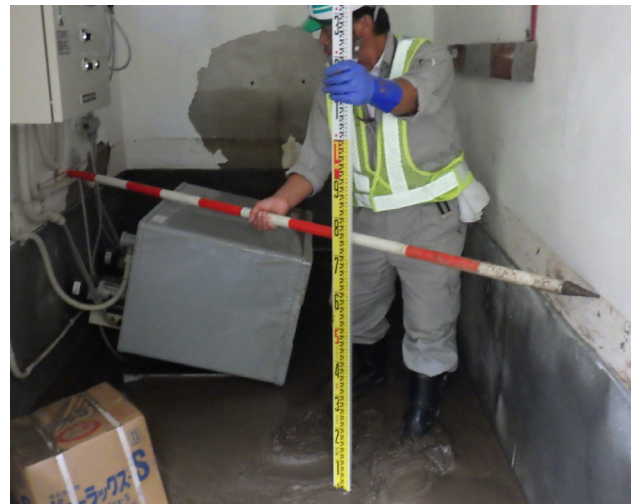
同じく浸水被害を受けた浄水場
