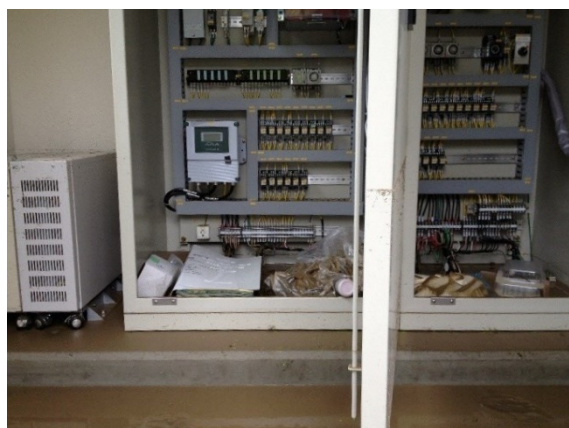
電気設備の嵩上げ前
