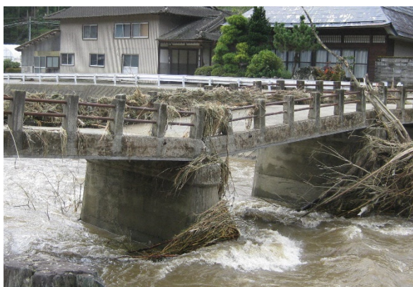
令和元年台風第19号で河川の増水により被害を受けた橋
