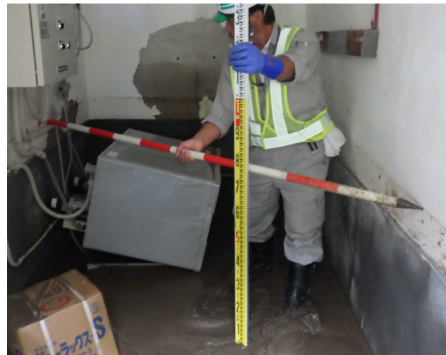
同じく浸水被害を受けた浄水場
