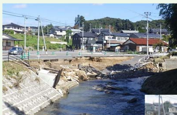
▲ 被災直後 (令和元年10月)
