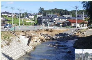
▲ 被災直後 (令和元年10月)
