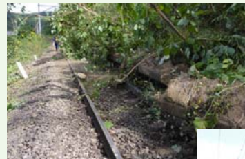
▲ 被災直後 (令和元年10月)
