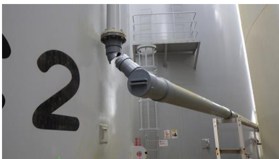
(写真 3 - 1) 雨樋破損状況の一例
