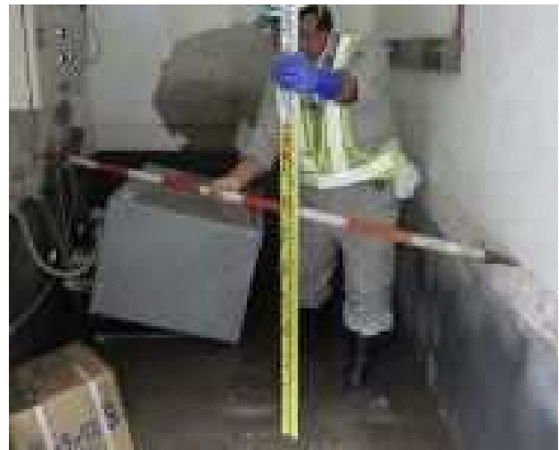
同じく浸水被害を受けた浄水場
