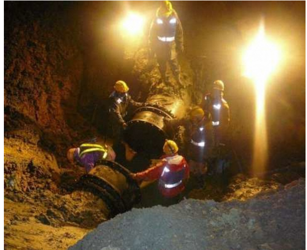
普段目にする事のない工事の様子 (昼夜を問わず行われた東日本大震災の復旧工事) 写真提供：いわき市
