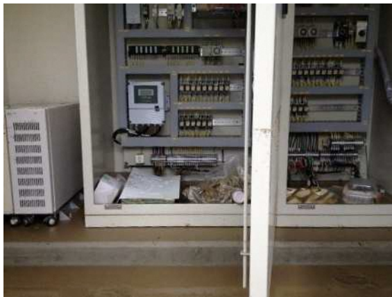
電気設備の嵩上げ前
