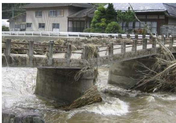
令和元年台風第19号で河川の増水により 被害を受けた橋
