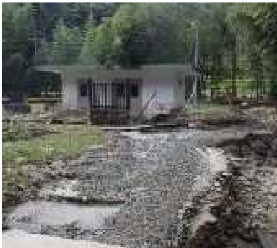
令和元年台風第 19 号で浸水被害を受けた取水施設
