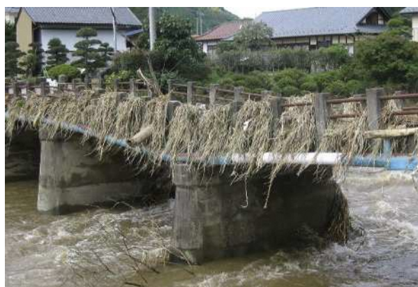
同じ橋の下流側に添架している水道管 (被害は受けたが、断水には至らず)
