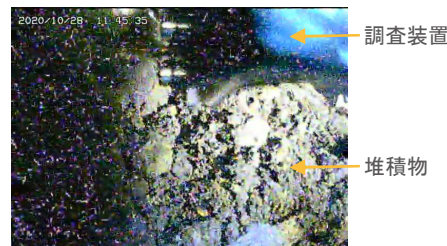
②堆積物の状況
