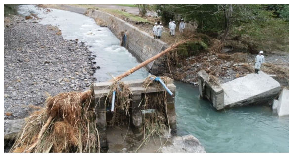
岡の内堰(棚倉町) 大型土のう等による仮復旧により 春の営農再開には取水することができた
