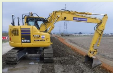
ICTバックホウ(アンテナ、ステレオカメラ搭載)
