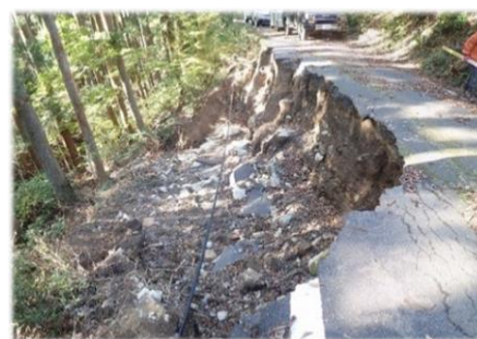
(林道「母成線」の被災直後の状況)
