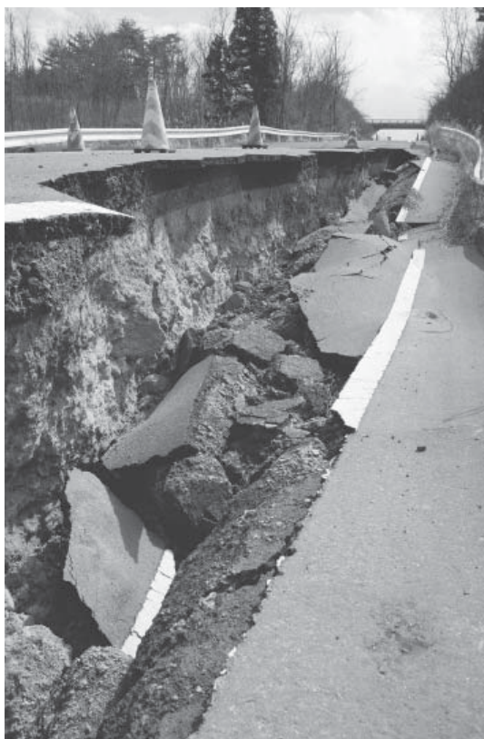
(道路の被災状況 松塚地内)
