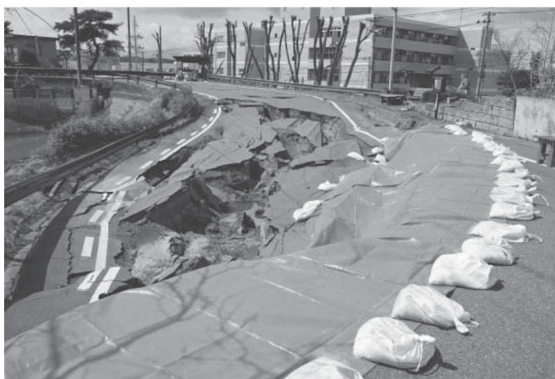
(道路の被災状況 八幡山地内)
