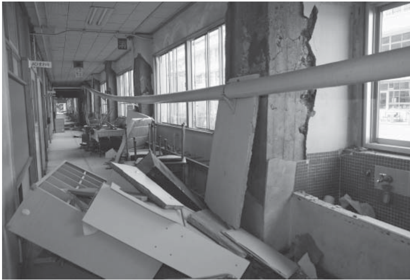
(被災状況 第一小学校校舎内)
