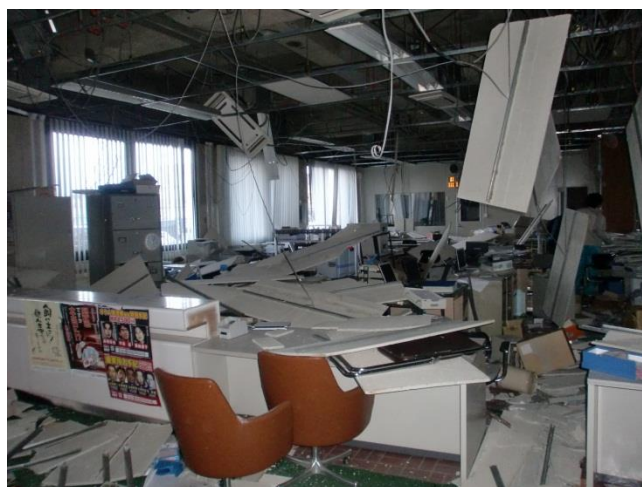
役場庁舎も大きな被害を受けた（1階窓口）
