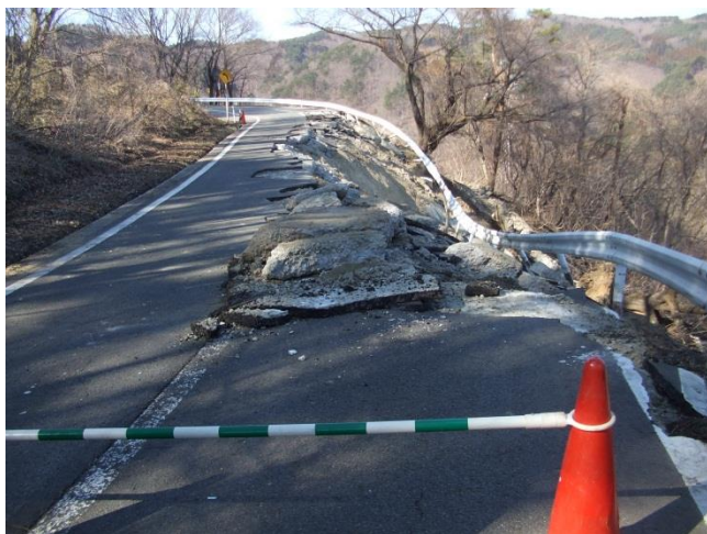
町内各所で道路が寸断した
