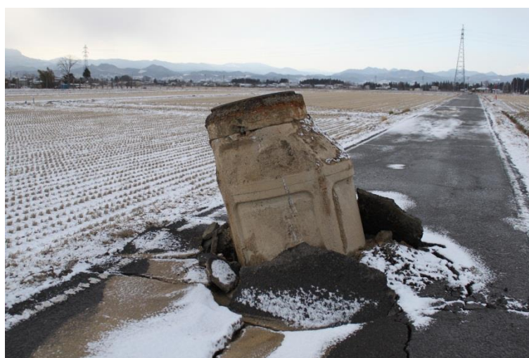
液状化により地上へ浮き出したマンホール
