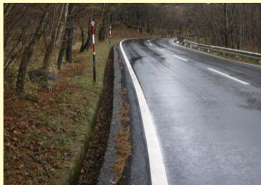
路肩がせまく走りづらい道路
