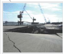
被災した小名浜港7号碼頭（いわき市小名浜）
