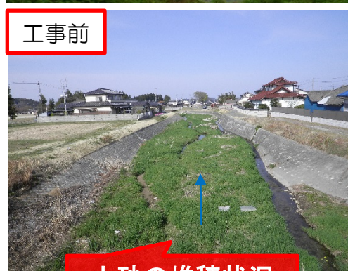
土砂の堆積状況
