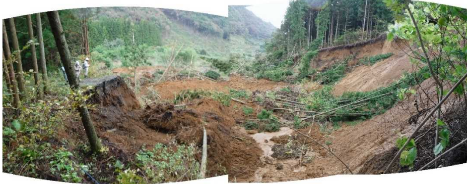
路体が崩落し、通行できなくなった林道（白河市、桜平犬神線）
