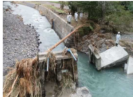
護岸及び堰体が損壊したことにより 取水ができない頭首工
