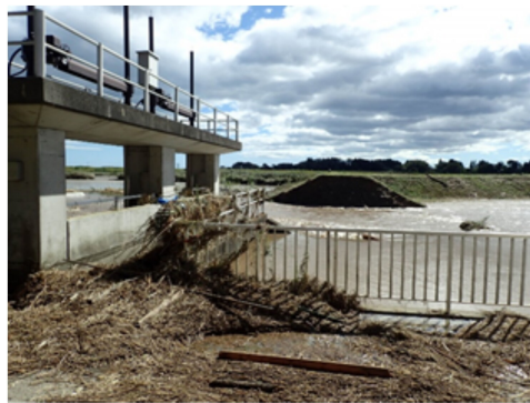
河川破堤箇所(相馬市)
