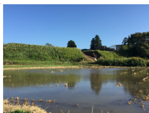
決壊したため池(玉川村)
