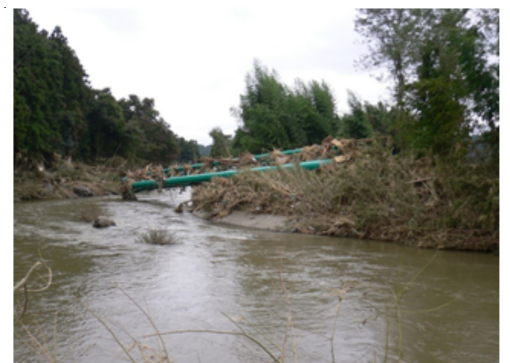
河川増水による水管橋の落橋(石川町)
