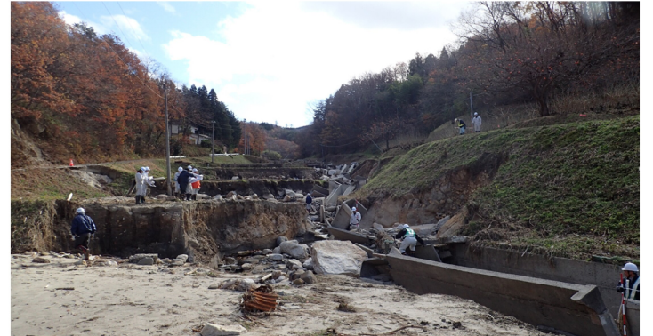
農業用排水路の被災状況(伊達市)
