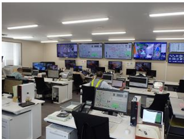
固型化施設中央操作室での稼働状況確認
