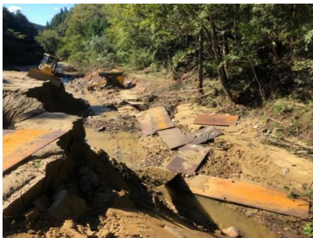
県営農道事業工事箇所の被害（遠野町内）
