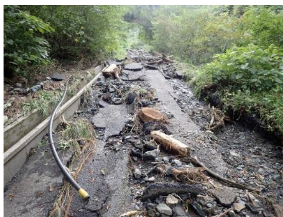
林道被害（路面洗掘）「宇津木沢」線（田人町黒田地内）
