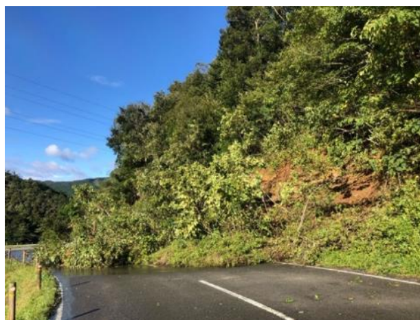
農道法面の崩落（遠野町内）
