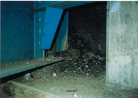
沓座への土砂堆積による沓の腐蝕(路面からの流入)
