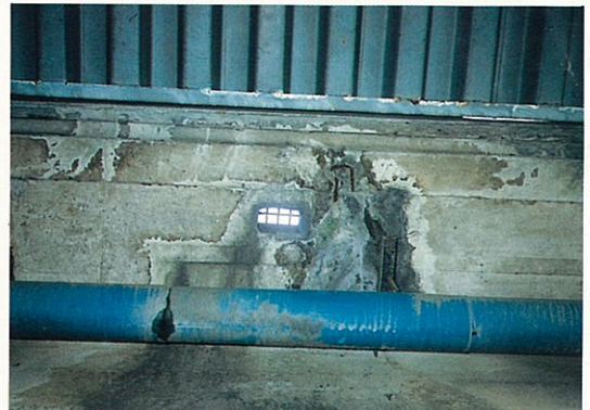
排水柵周辺部の漏水による破損
