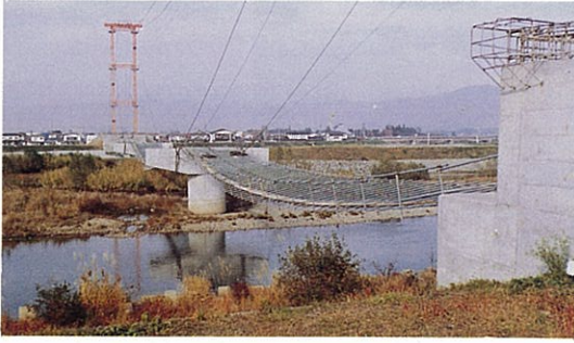
1) 鉄塔とワイヤーブリッジ設備
