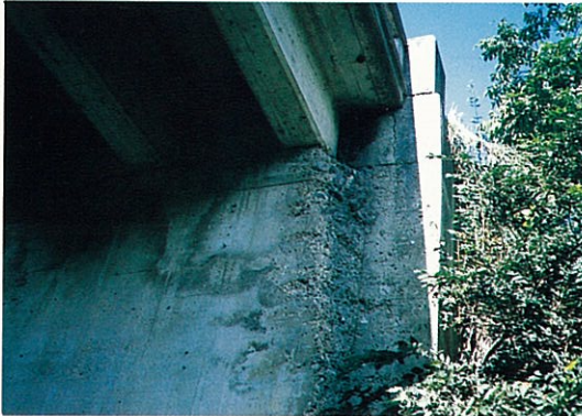
凍結融解による橋台桁受部の破損
