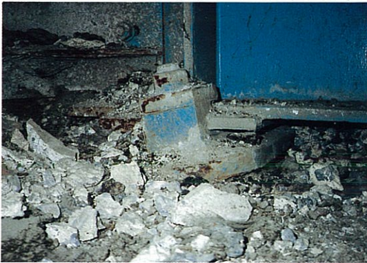
アンカーボルトの抜け出し、沓座モルタル破損
