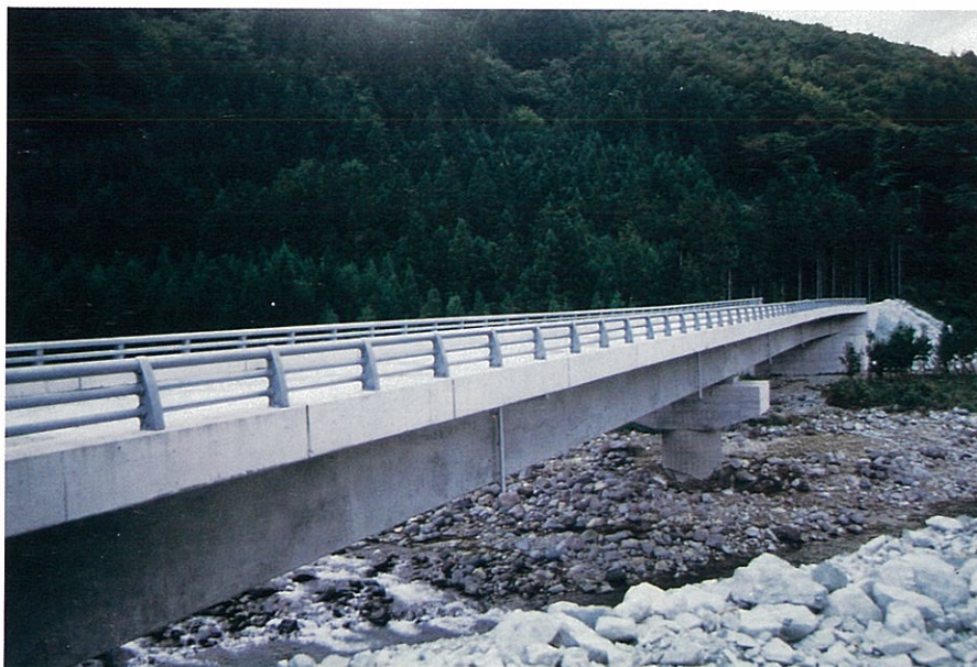
須賀川田島線の改良は枝松橋の完成により大きく前進することが期待できる。
