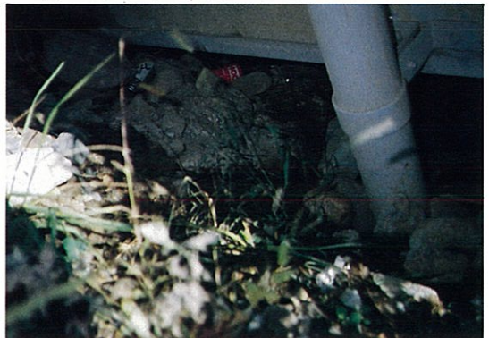
沓座への土砂流入 (側面からの流入)
