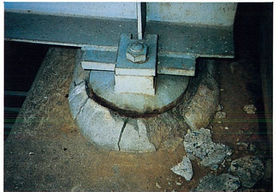
沓座モルタルの破損
