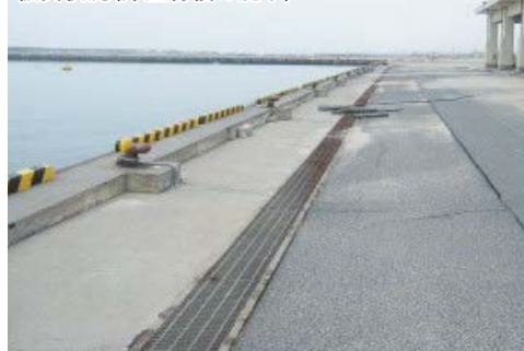
被災状況(岸壁背後の沈下)
