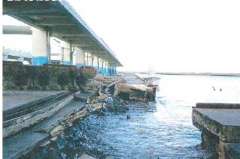
被災状況(岸壁崩壊)
