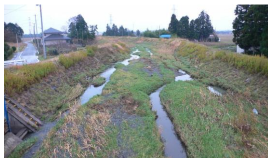
下流域の状況（支川立田川）
