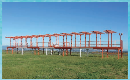
ローライザー (LOC) 着陸のため進入中の航空機に対して滑走路中心の左右のずれを電波によって示す装置です。
