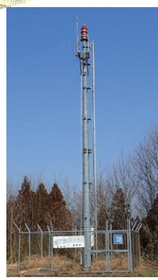
航空障害灯 (OBL) 水平表面から突出している地形の位置を示すための灯火です。(場外)
