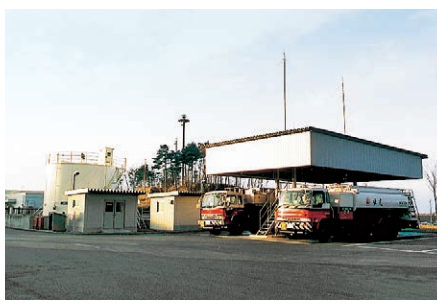
給油施設 (POL) 航空機に給油するジェット燃料を扱っており、200klタンク1基を有しています。
