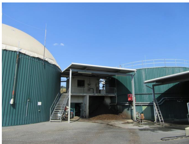
【牧草を燃料としたバイオガス発電施設】
