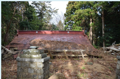
倒壊した社殿（現在撤去されている）
