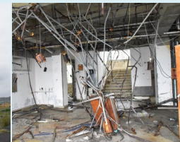
内部の被災状況
