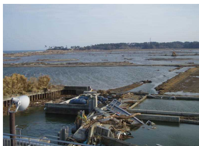
八沢浦排水機場の被災状況
