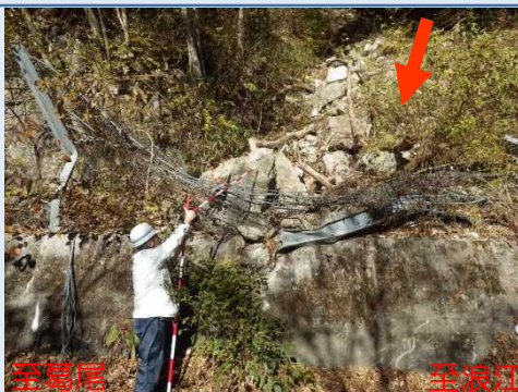
山腹崩落による道路施設被災
