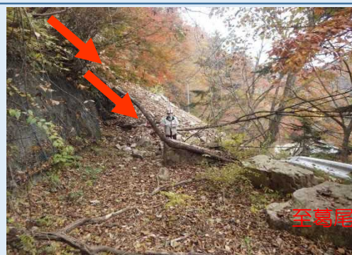
山腹崩落による被災（通行不能）
