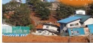
家屋被害の状況（福島市伏拝地内）
