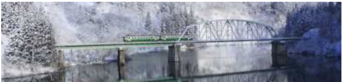
第五只見川橋りょう(金山町)※現在不通
