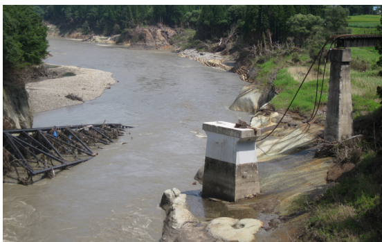
流失した第七只見川橋りょう(金山町)
