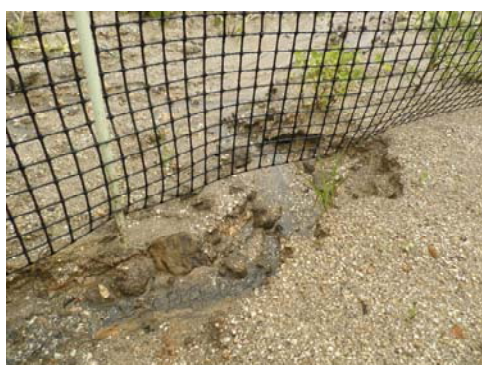
図3 防護柵下部の土壌浸食状況
