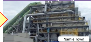
Eine temporäre Müllverbrennungsanlage
