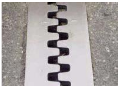
伸縮装置の遊間が異常に広い状態の例
