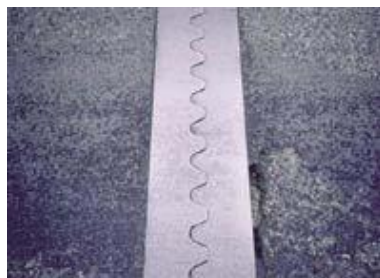
伸縮装置の遊間が異常に狭い状態の例
