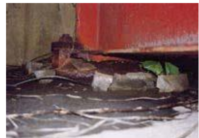
沓座モルタルの損傷の例
