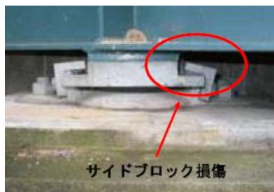
サイドブロックの損傷（ベアリング支承）
