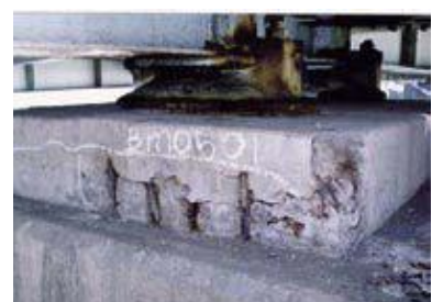
台座コンクリートの損傷の例
