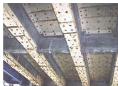
鋼板接着工法の鋼板の錆が著しい例
