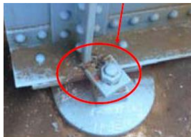
ピンチプレートの損傷（線支承）
