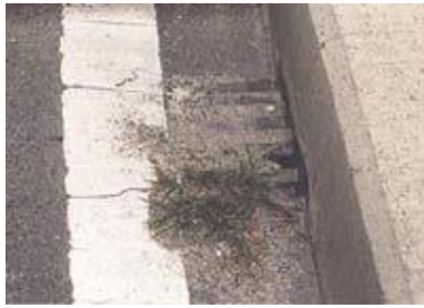
排水ますの土砂詰まりの例
