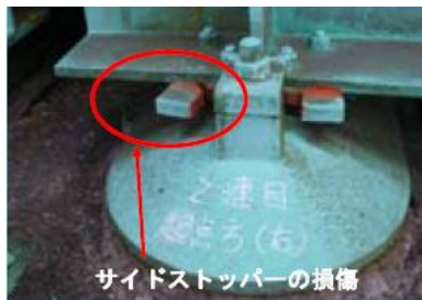
サイドストッパーの損傷（線支承）
