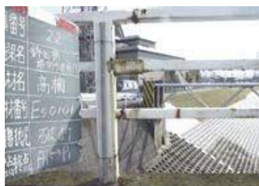
高欄の連続的な腐食と一部破断の例
