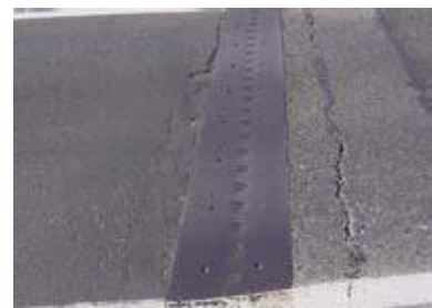
伸縮装置の遊間が完全に閉じ、舗装にひびわれが生じた例
