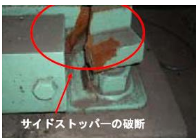
サイドストッパーの損傷（ベアリング支承）
