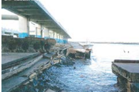
松川浦漁港(被災状況)
